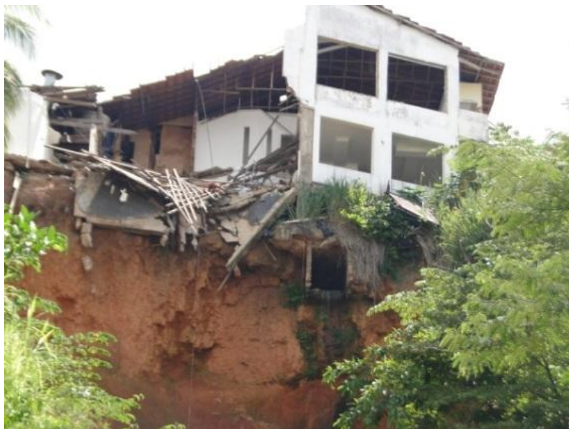
Figura 28: Imóvel comercial em risco de deslizamento. Dezembro de 2013
