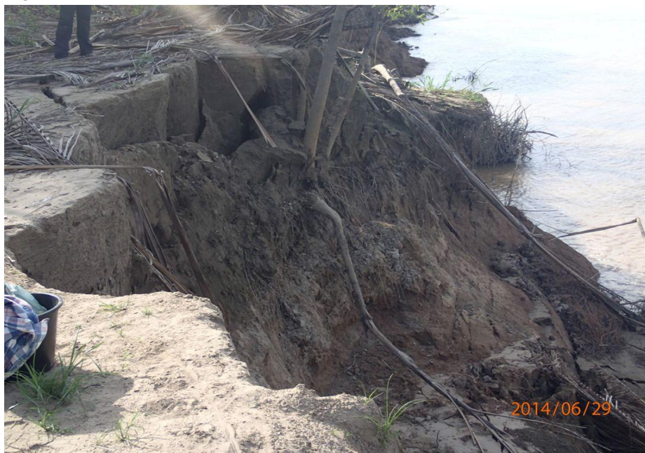
Figura 7: Erosão no rio Madeira, Porto Velho
